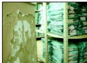
Infiltrações podem danificar arquivos...
