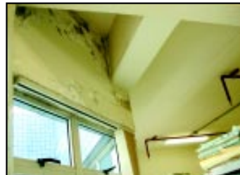
... assim como mofo e vazamentos
